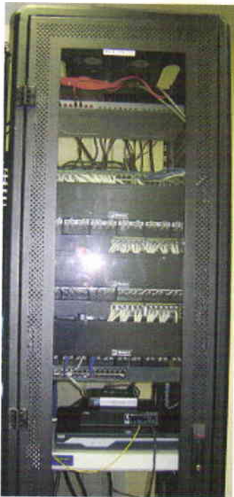
Equipamiento Central de Datos
