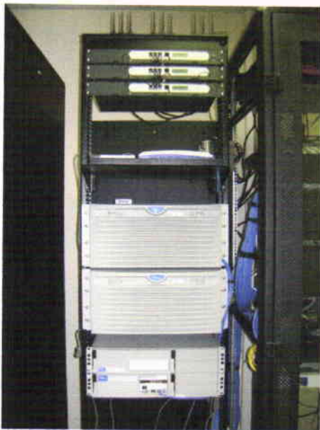
Equipamiento Central Telefónica
